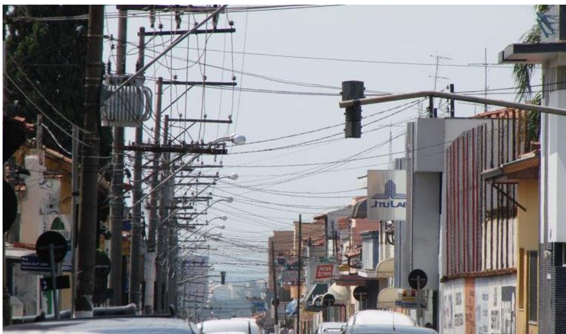
Figura 15 – Aspecto visual fiação no Centro Histórico
